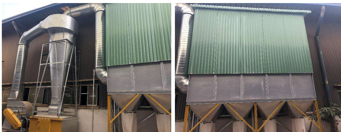
Hình 3.12. Hệ thống xử lý bụi từ công đoạn chà nhám, hoàn thiện sản phẩm
